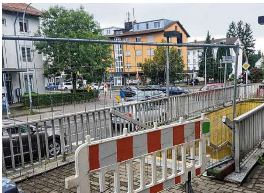
Die Allmannsdorfer Unterführung ist schon wieder wegen Schäden gesperrt, die Kreuzung wird rege genutzt. BILD: KIRSTEN ASTOR
